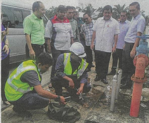
Tindakan pemotongan bekalan air turut dikenakan terhadap premis kilang haram yang beroperasi di sekitar Teluk Gong.
